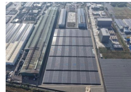
太陽光発電システム
