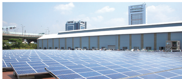
泉大津工場 太陽光発電設備
