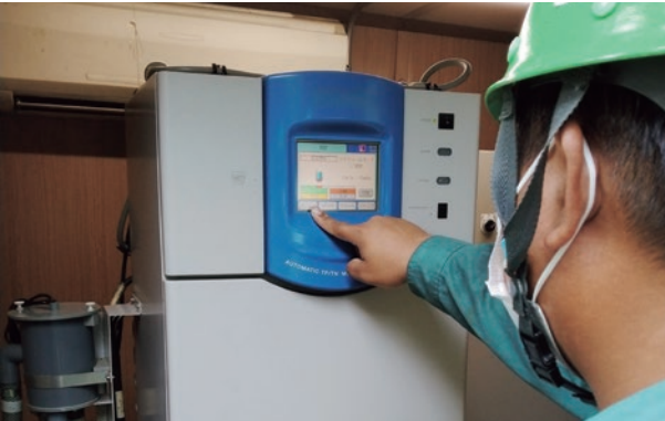
市川工場 全窒素・全りん測定装置
