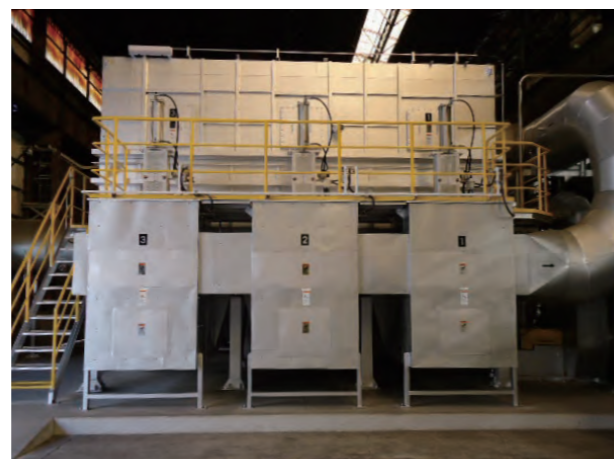
呉工場 カラーライン脱臭装置 高い排ガス処理能力と省エネ効果で、環境保全に貢献しています
