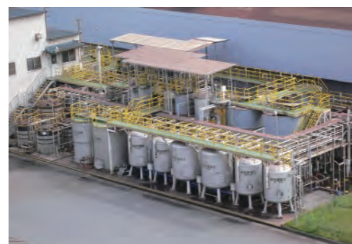
呉工場 表面処理工場廃液処理設備
