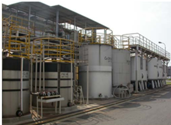
呉工場 廃液処理設備
