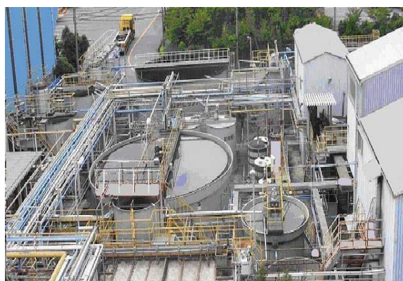
市川工場 総合廃液処理設備
